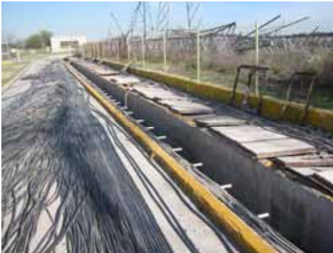
Fig. 3. Cable de control sustituido por enlaces de fibra óptica.
